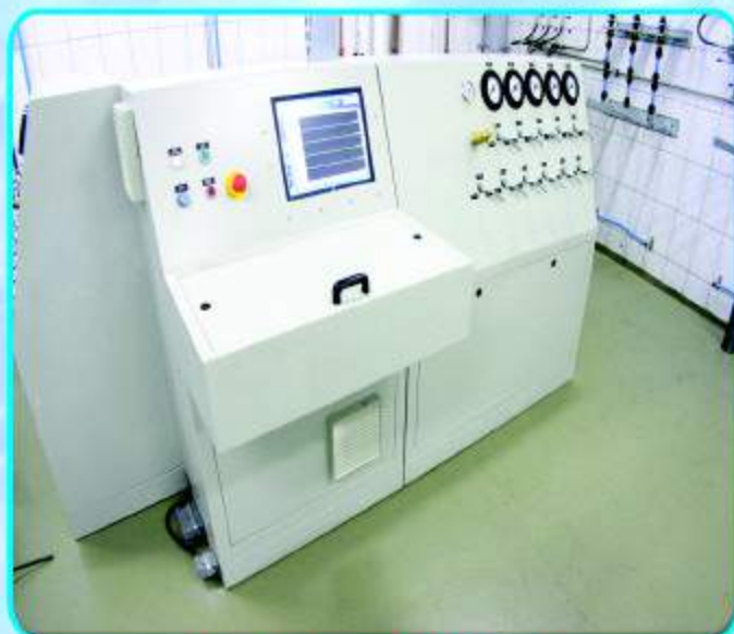
PAINEL DE CONTROLE - LABORATÓRIO
